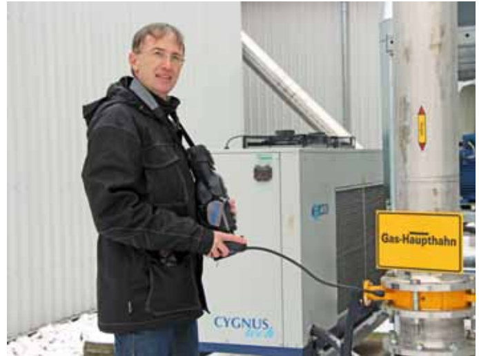
☛ Die undichte Stelle ist gefunden, jetzt kommt das Gasspürgerät zum Einsatz.
